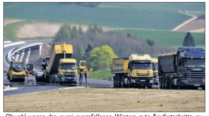
Obwohl wegen des quasi ausgefallenen Winters gute Baufortschritte erzielt werden konnten, ist noch einiges zu tun.
